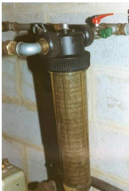
Filtre primaire de 10 µ en aval du groupe hydrophore. Ce filtre produit de l'eau pour usage sanitaire dont l'absorption accidentelle ne nuit pas à la santé.
